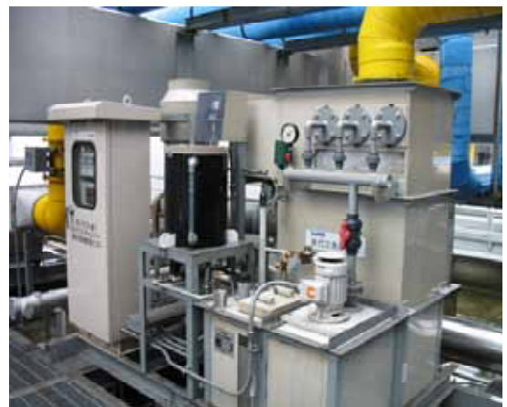
本部 屋上のスクラバー(排気ガス洗浄装置)
