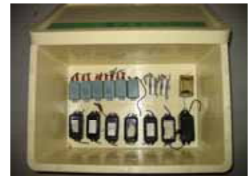
本部内で保管している安定器等
