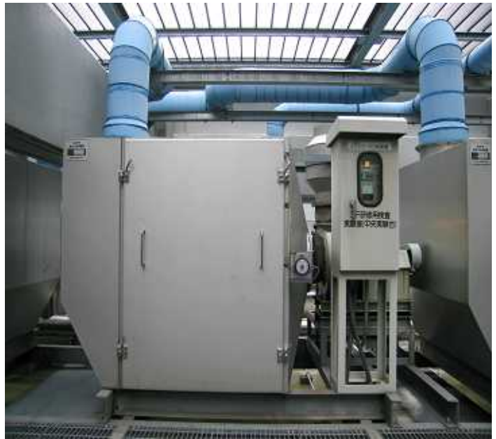
有機溶剤用脱臭装置
