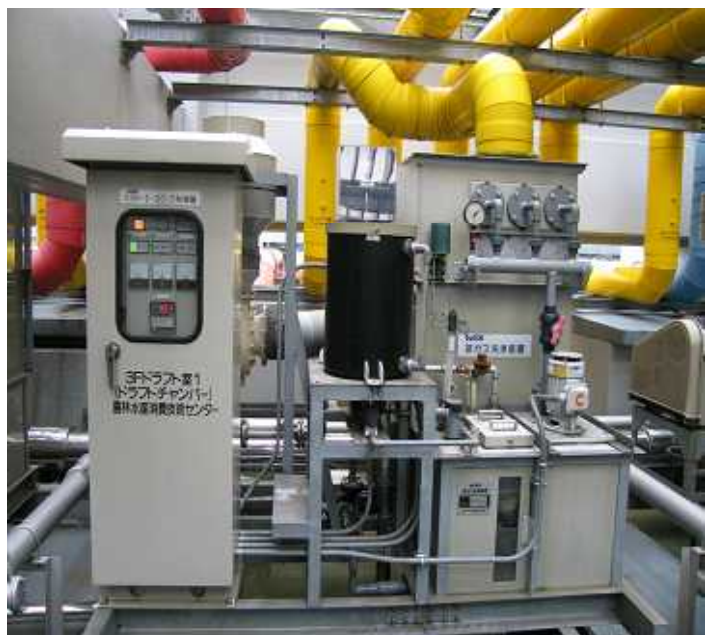
酸性ガス用排ガス浄化装置
