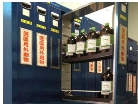
薬品保管庫内部
