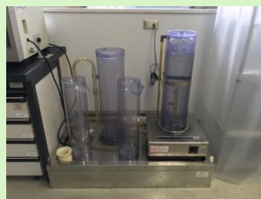
神戸(一般成分検査室 排水パン)
