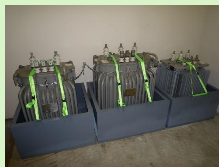
高圧トランス
