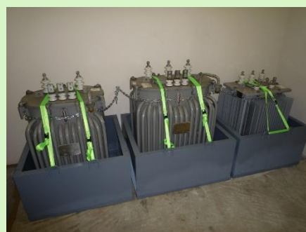
高圧トランス
