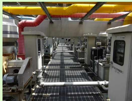
屋上スクラバー群 本部（屋上）
